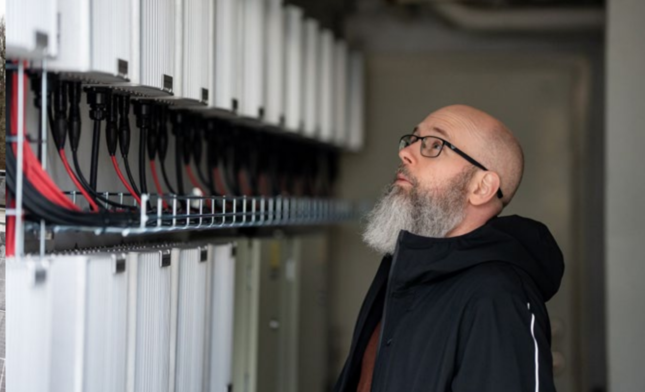
Kamrer Marcus Andersson tar en titt på det system som han hoppas skall ha en gynnsam effekt också på skolans elräkningar.
